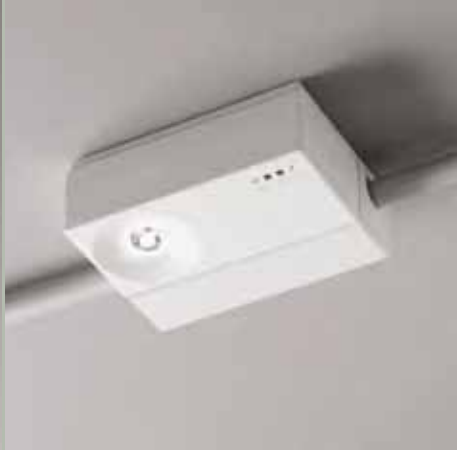
K7 met doorvoerbedrading - webref. SK7005A3A
