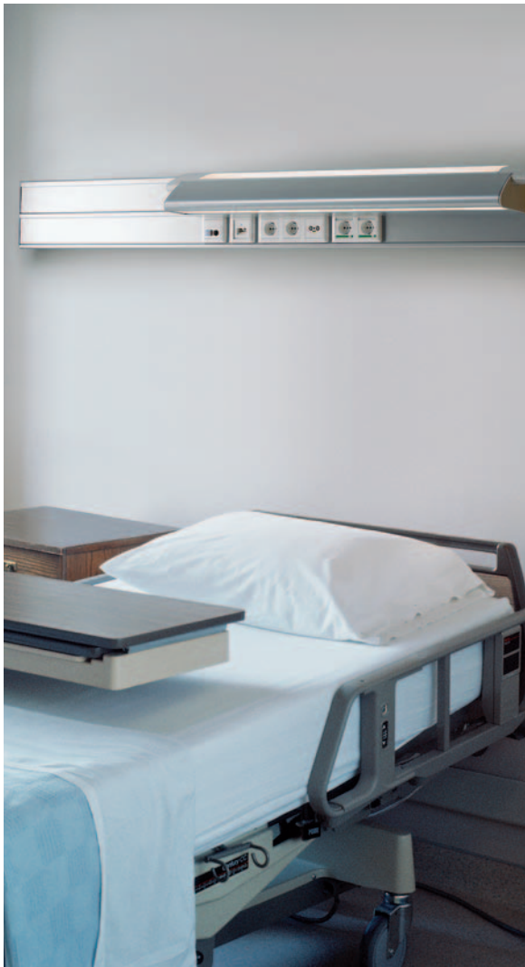
Kanaal op maat met Medilux® verlichting en verschillende medische voorzieningen
