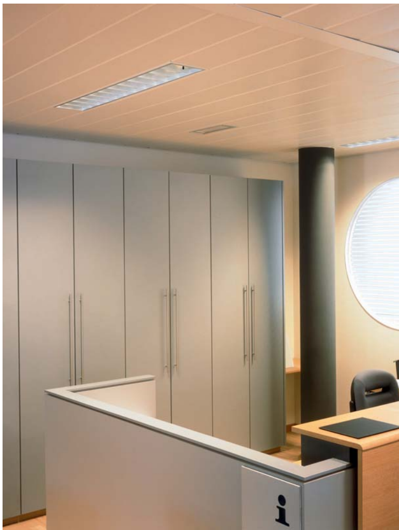
DALI-ELS: onopvallend ingebouwd in U3-armaturen.
