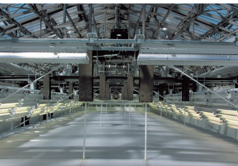
De ETAP verlichtingsinstallatie bevindt zich boven de koepel.
