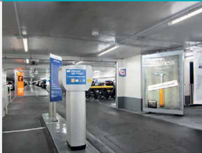
Dankzij de aanwezigheidsdetectoren hoeft de verlichting niet continu te blijven branden.
