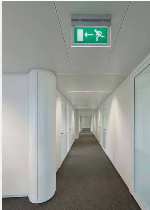
De K9-armaturen met led zijn gekoppeld aan de ETAP Safety Manager zodat op elk moment kan worden nagegaan of alle armaturen correct werken.
