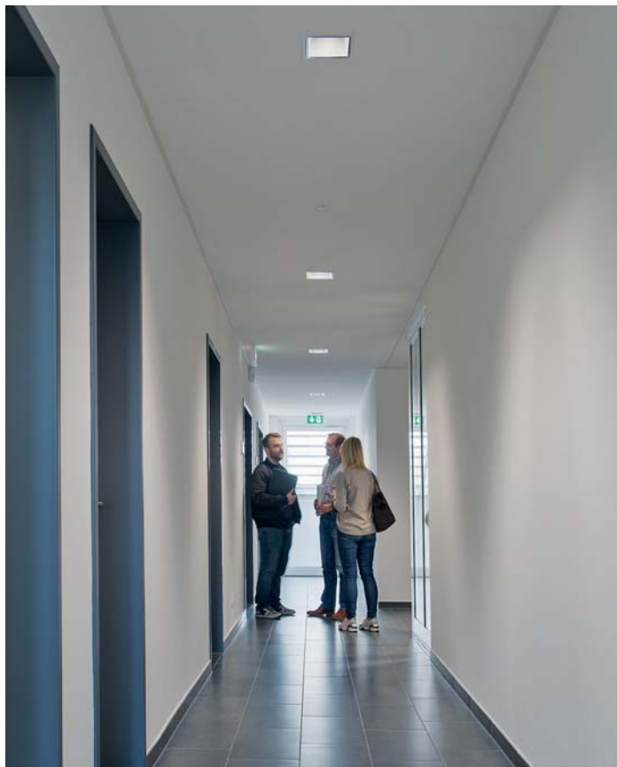
Aanwezigheidsdetectie in de gangen: wanneer er 10 minuten geen beweging is, dimt de verlichting tot 20%.
