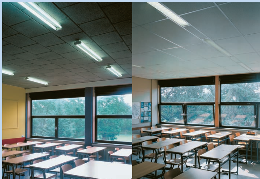
In de klassen van het Lorentz Casimir Lyceum leveren de bewegingsmelders nog een extra besparing op. De energiezuinige verlichting compenseert perfect het meerverbruik van de computers.
